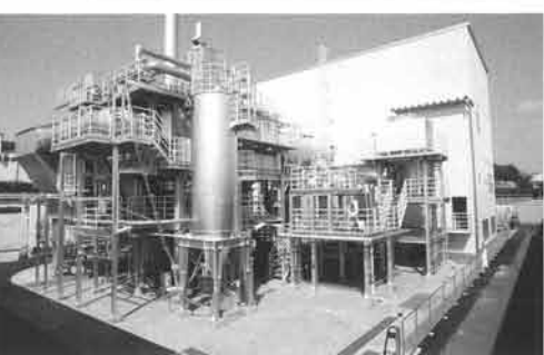
敷地面積686㎡、建築面積349㎡。ここにACEPすべての設備が集約されている
