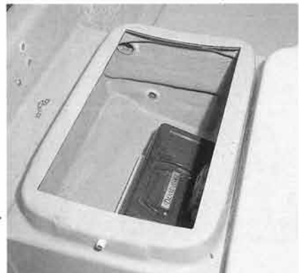
デッキ下(バッテリー〜魚探)のケーブル用配管
