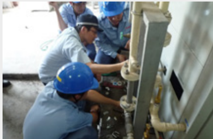
ベトナムYPMVにて、エア―コンプレッサーの運用改善指導を実施
