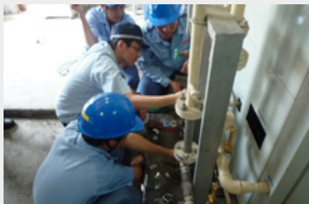
ベトナムYPMVにて、エアーコンプレッサーの運用改善指導を実施
