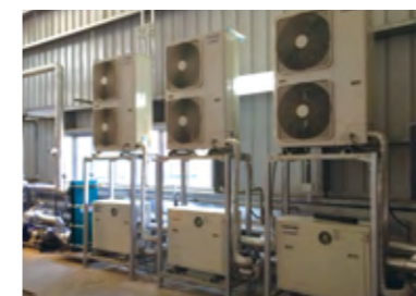
インド チェンナイ工場のヒートポンプ
