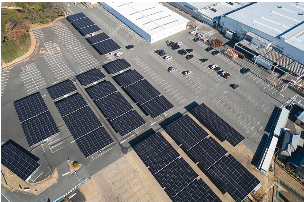
従業員用駐車場に新設したカーポート型太陽光発電設備
