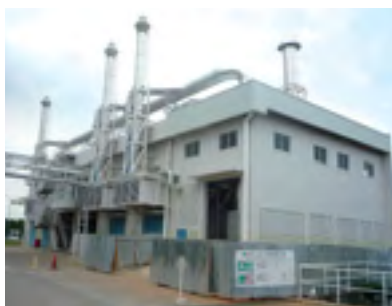
YMMWJのガスエンジン発電機 【仕様】ガスエンジン発電機2,735kW 3台設置 【蒸気使用先】樹脂塗装・鉄塗装・ダイキャスト 【LPG燃料削減によるCO 2 削減量】△400t-CO 2 /年 *YMMWJ: PT. Yamaha Motor manufacturing West Java
