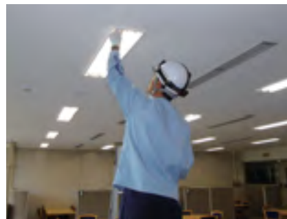
照明を蛍光灯からLEDに交換することなどで、電力使用量削減に取り組んでいます。
