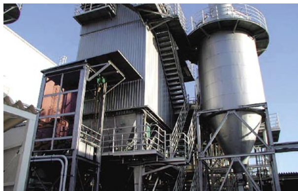
減温塔にて 200℃以下に急冷したあと、活性炭を吹き込み、バグフィルターにてばいじんを捕集する。
