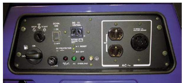
図9 片面集中コントロールパネル
