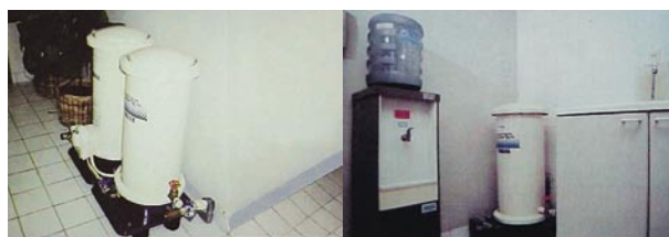
図3 マンションでの設置
