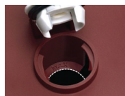
Entlüftungsschacht mit Füllstandsanzeige
