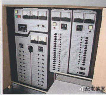
⑪配電装置
