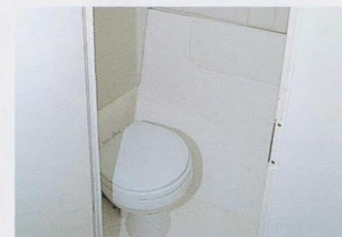
トイレルーム、マリントイレ
