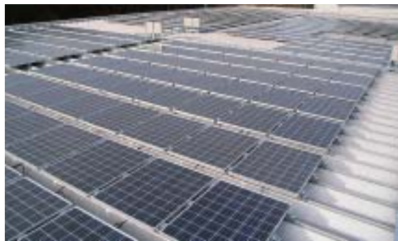
森町工場の太陽光発電設備
