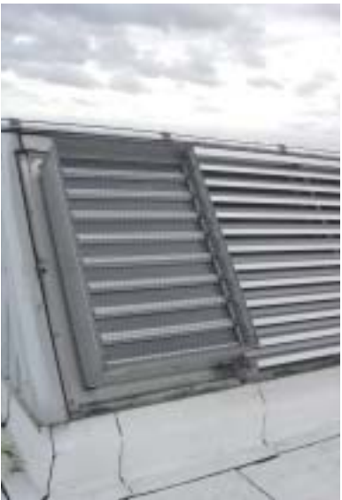
屋内の温熱を外に逃がす換気口
