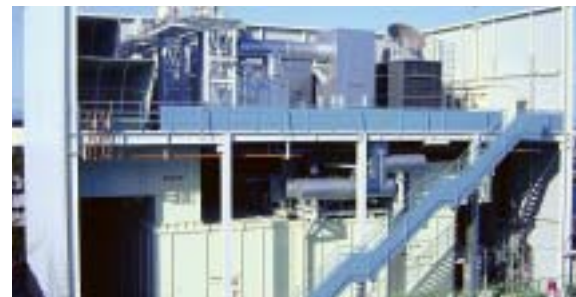
第3・第5サイト(現・磐田第2工場/第2SyS天竜/ヤマハマリン天竜)のコージェネレーションシステム
