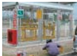
新たに導入されたタイ拠点の天然ガス設備
