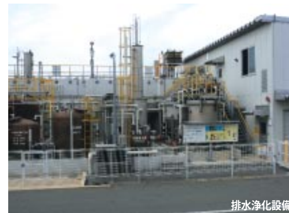
排水浄化設備
