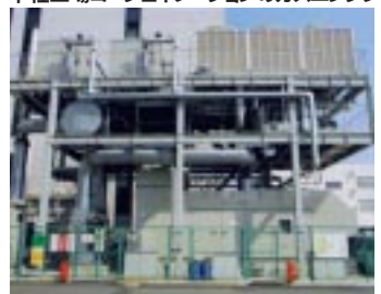
本社事務棟コージェネレーションの全景
