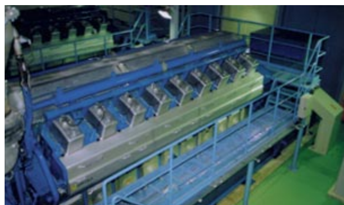
本社工場コージェネレーションのガスエンジン
