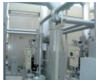
中瀬工場コージェネレーションの内部
