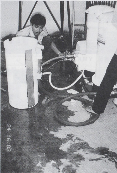
写真8 定期メンテナンス風景(水量測定)
