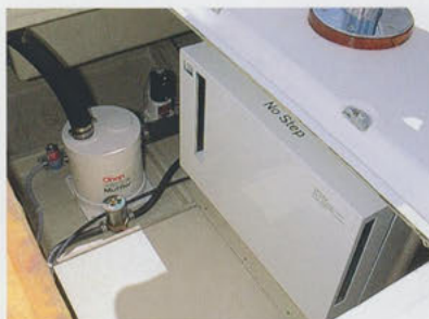
●発電機 エアコン用の発電を行なう6kwの発電機。
