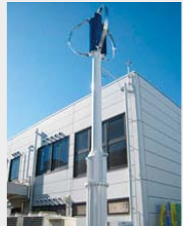
プロペラ型に比べ、静粛性に優れた縦型風力発電システム（中瀬工場）
