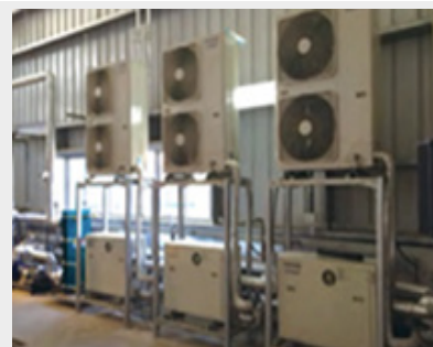
インド チェンナイ工場のヒートポンプ
