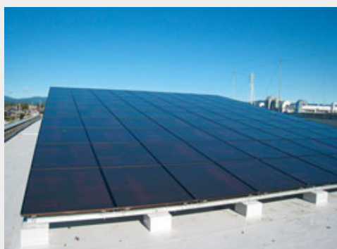
NEDOとの共同研究事業として導入した太陽光発電システム（中瀬工場）
